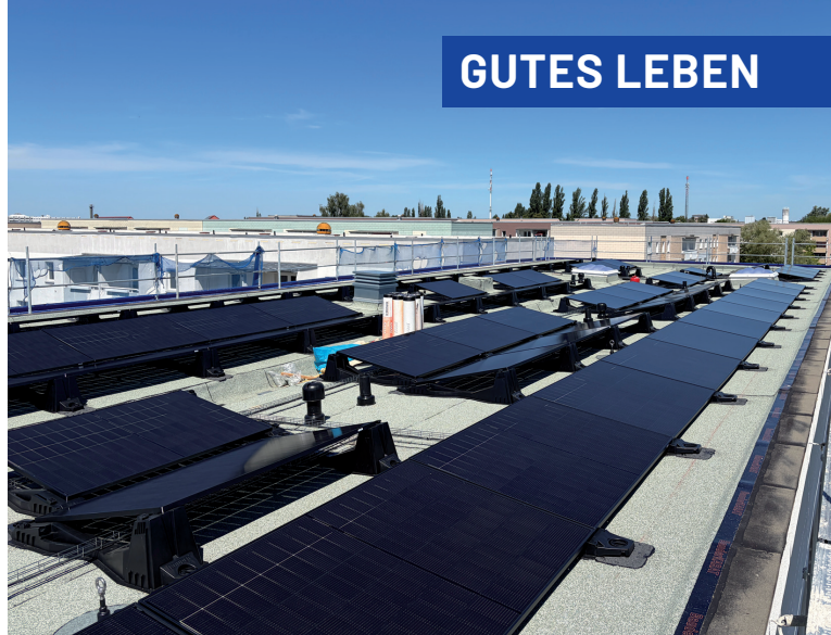
Neue PV-Anlage der Stadtwerke Schkeuditz auf der Zeppelinstr. 21-27
